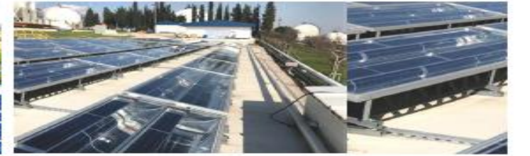
İPRAGAZ /20kWp 80 ADET /İZMİT /2018
